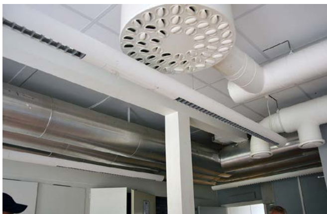
Kraftiga ventilationskanaler i östra byggnaden
