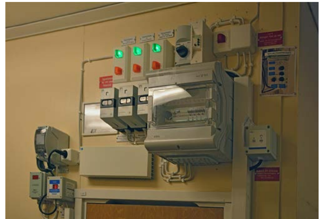
Automatik för pump och ventilation i gymnastiksalen
