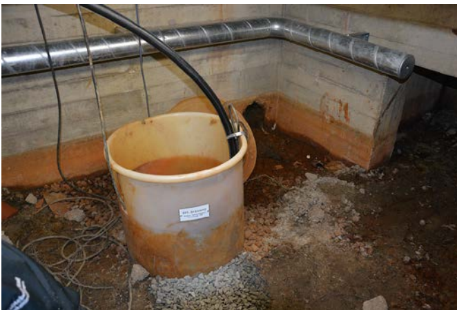
Grundvattenpumpning i gymnastiksalen. Obs märken på väggarna efter lång tids vattenstånd.
